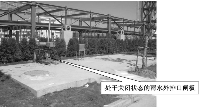
图 A. 28 雨水外排口闸板阀
